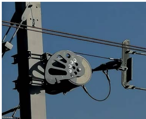
Nowoczesne urządzenie naprężające sieć trakcyjną. Materiał własny. | A modern device for tensioning the traction network. Own material.
