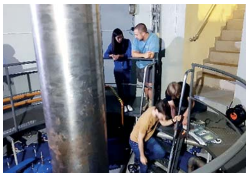
Członkowie SKN IsklErka podczas instalowania układów pomiarowych na wale generatora | Members of SKN IsklErka during installing measurement systems on the generator shaft
