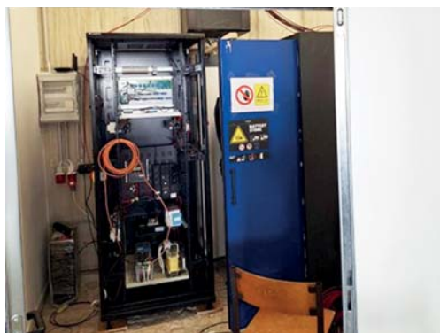
Rys. 3. Widok na szafę rack demonstratora POWERSKIN+ w części baterijnej | Fig. 3. View of the POWERSKIN+ rack – battery module
