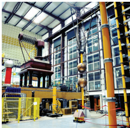
Hala Wysokich Napięć, IETiSiP | High Voltage Hall, IETiSiP
